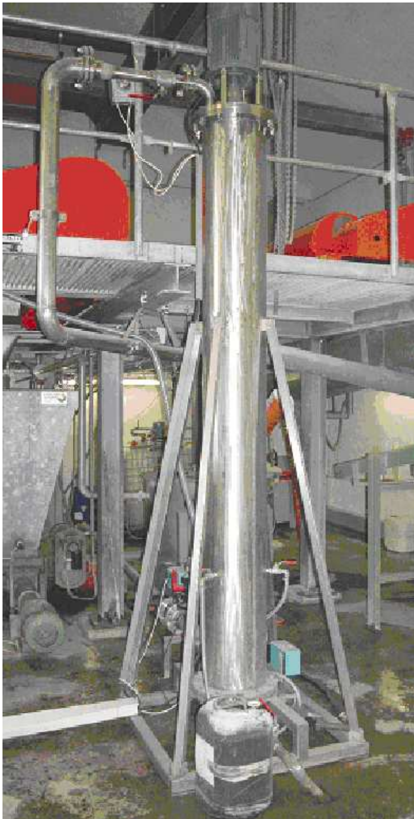
Abbildung 3.2: Vortex-Mischer, installiert auf der Kläranlage Seesen
